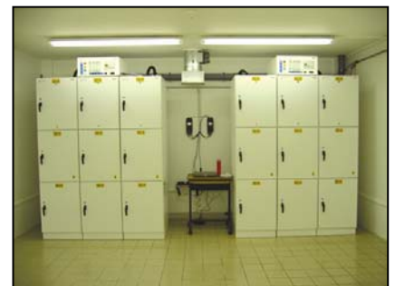
Armoires sous azote – Local sécurisé
